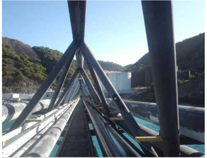
Tuberías de Statia, St. Eustatius
